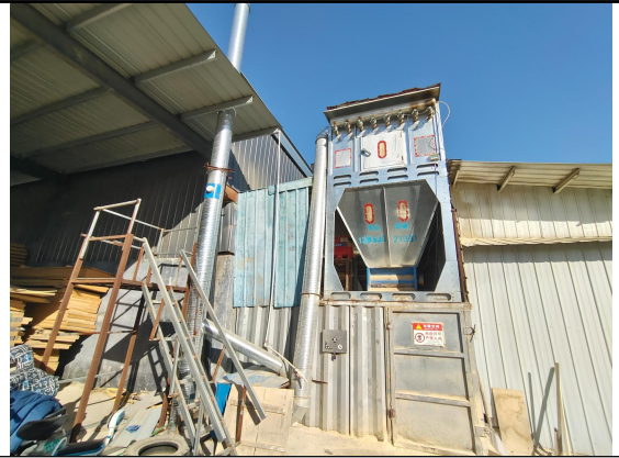
布袋除尘器排气筒 P2
