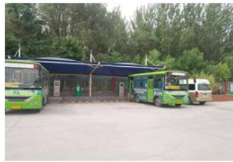
阳谷县丰源公交有限公司北站充电站
