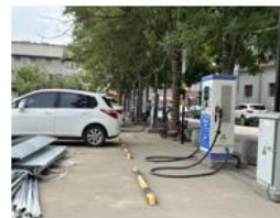
狮子楼景区停车场充电站
