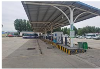
阳谷汽车站直流充电站
