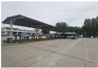
阳谷汽车站直流充电站
