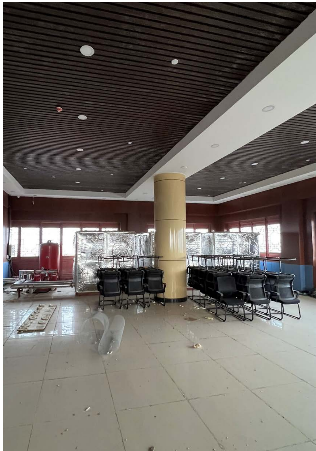
开敞空间及消防水箱设备
